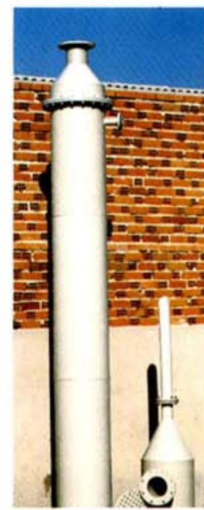
Torre de lavado de gases.
