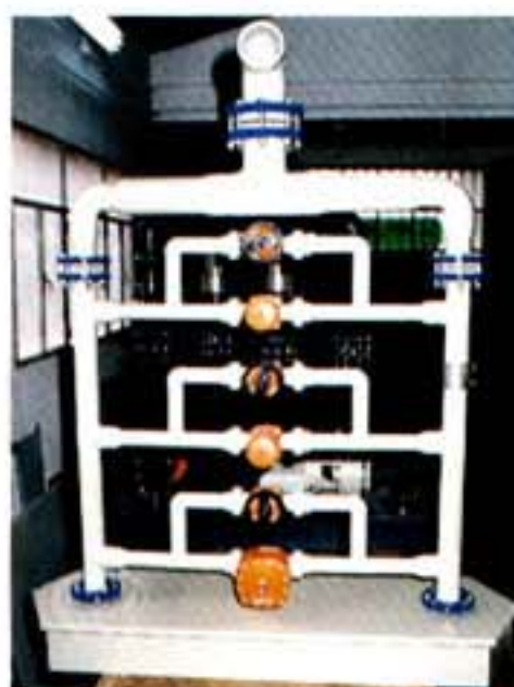
Conjunto de valvulería.
